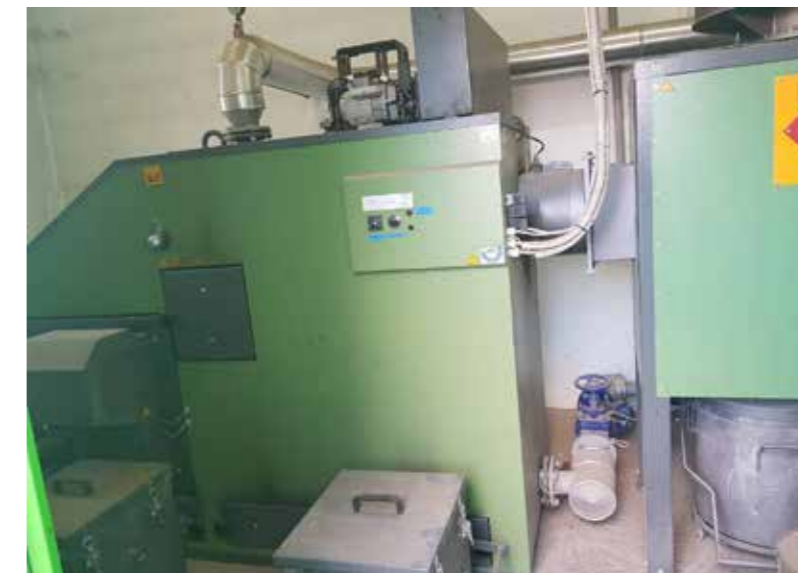
Sječka se koristi kao bioenergent za opskrbu toplinskom energijom
