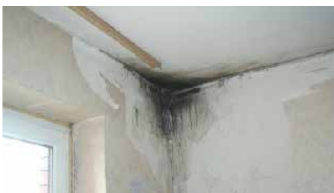
Gljivice i plijesan česta su pojava u stanovima. Jedan od mogućih uzroka su hladni mostovi koji su posljedica neispravne sanacije. Uz to, sve više do izražaja dolaze posljedice „pretjerane štednje“. Stanovi se ne provjetravaju, a kvalitetna stolarija stvara učinak „hermetički“ zatvorenog prostora. Kuhinjska isparavanja i ostali oblici koncentracije vlage također pogoduju pojavi gljivica i plijesni.
