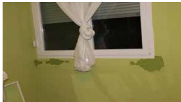
Prozori danas uglavnom zadovoljavaju potrebe za postizanje ušteda, ali vrlo se često javljaju problemi kod ugradnje. Ljudi katkad žele uštedjeti prilikom ugradnje, ali ubrzo dobiju problem koji se poslije teško rješava.
